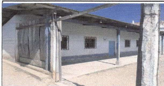
Foto 3: Sustrucción de porton de metal
